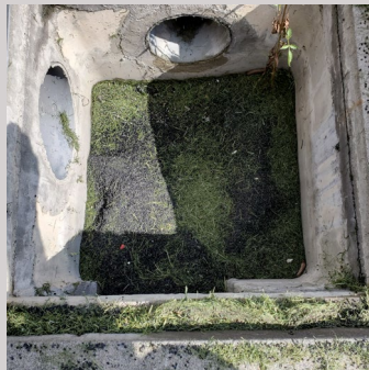
集水枥には人工芝と ゴムチップが堆積している
